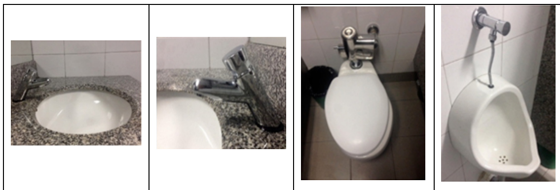
Imagen 15. Cambio de tecnología de suministro de agua en baños
